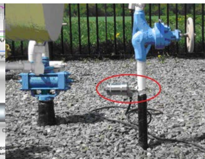
моноблок САКПП на крановой площадке
