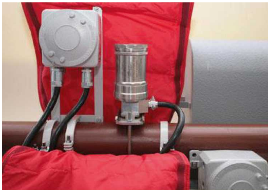
Датчик-сигнализатор ДС-АКЭ-2 на газопроводе
