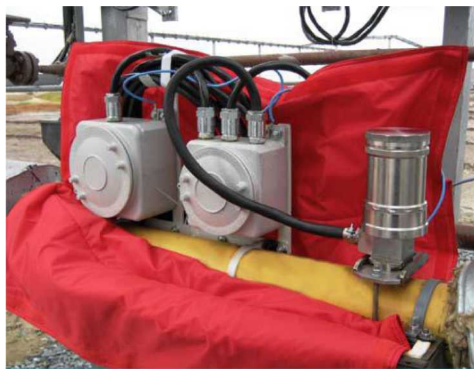
ДСП-АКЭ на газопроводе
